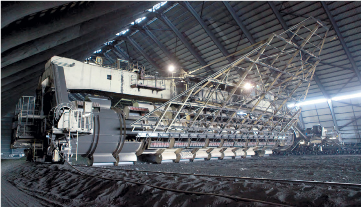
Abb. 3: Blick in die Rohkohlenmischhalle der Schachanlage Auguste Victoria 3/7, Marl, 2012 (Foto: RAG Aktiengesellschaft)
